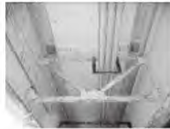
図-2 計測器設置
