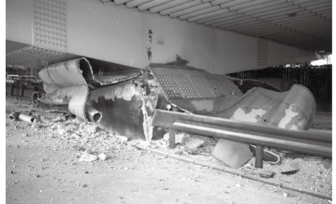
写真-2 缶切りで切ったようにつぶれた鋼製橋脚
