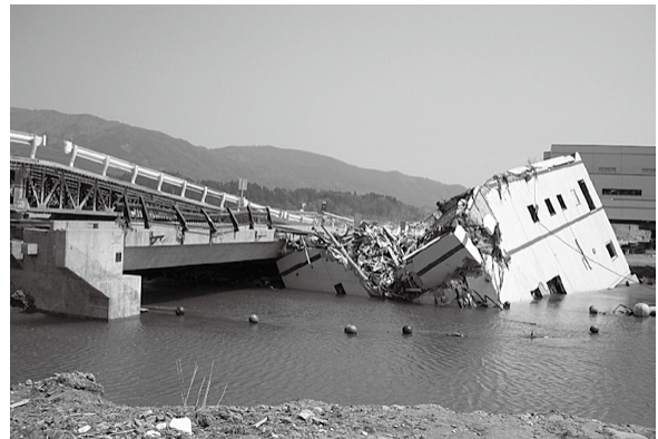
川原川橋被災状況
