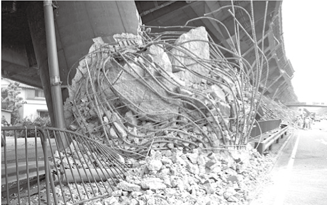
写真-1 主鉄筋段落とし部に生じた鉄筋コンクリート橋脚の破壊
