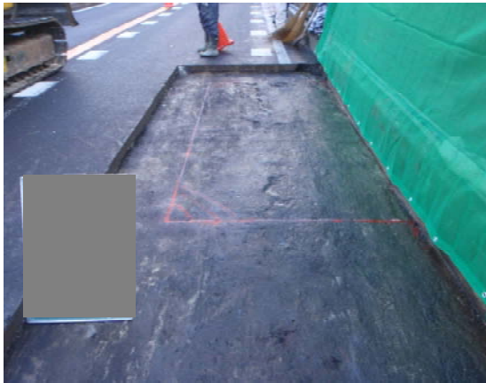
舗装切削後の床版状況(浮き)
