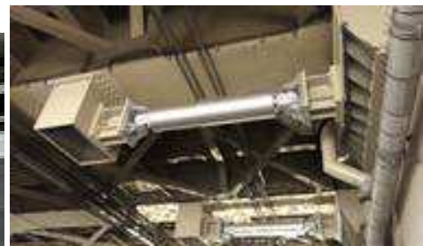
図-6 赤羽橋での設置例
